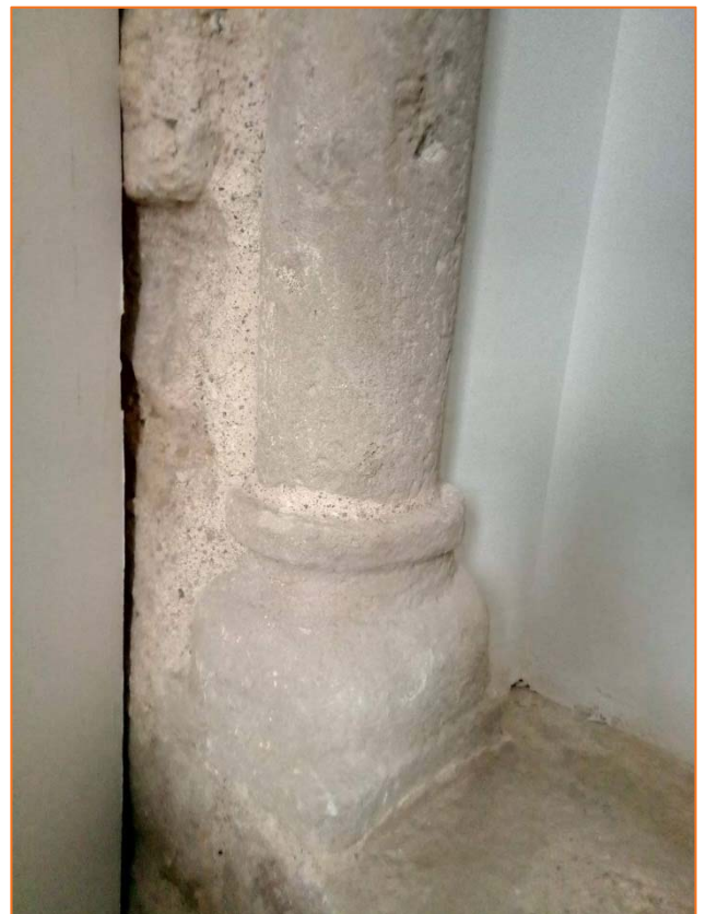
Foto 34. Detall de la basa del mainell de la finestra UE 122 un cop restaurada. Planta 2.
